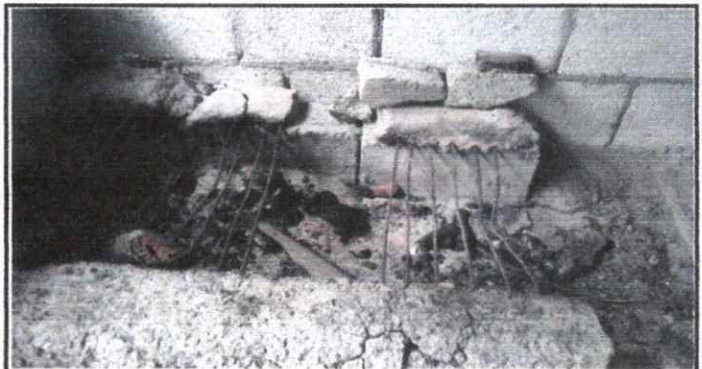
Foto 4: polleton en mal estado.
