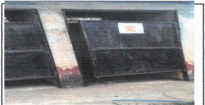
Foto 6: Puertas en mal estado.
