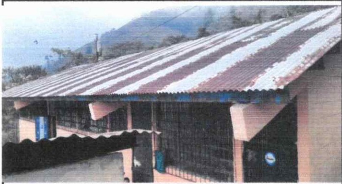
Foto 1: Se observa estructura de lámina en mal estado
