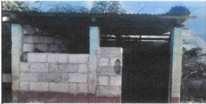
Foto 3: parte frontal de la cocina con necesidad de intervencion.
